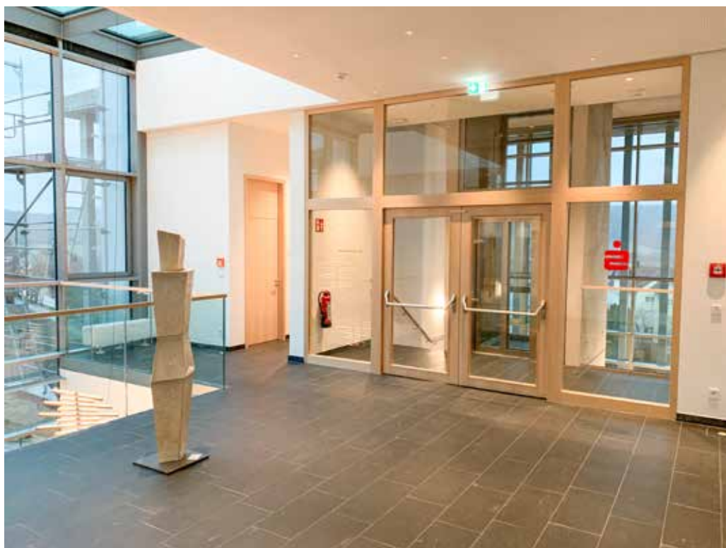
KÖ-PRBILD-TM0003 Glaswand mit F30-Brandschutzverglasung.
